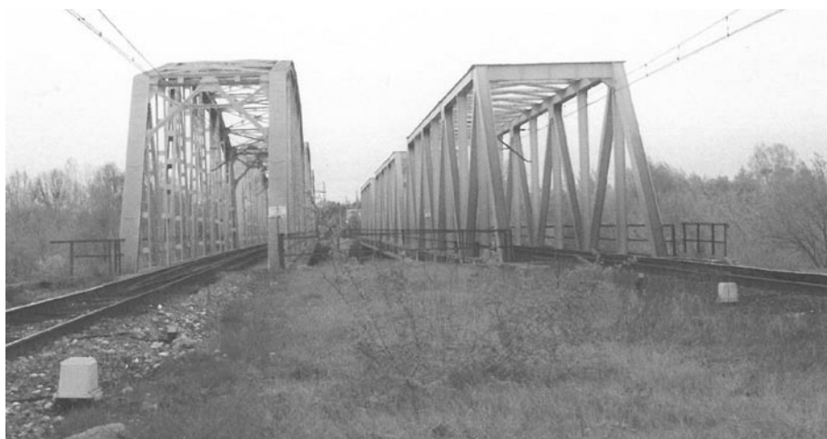
Most kolejowy na Wieprzu, który miał być uszkodzony.
